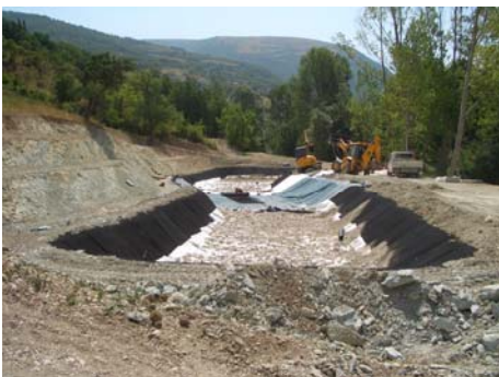
Acquacanina. Località Piè di Vescia, lavori di realizzazione vassoio sub-superficiale, stesura teli di contenimento
